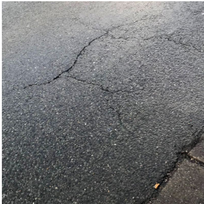
Ex: fissure transverse sur une route
